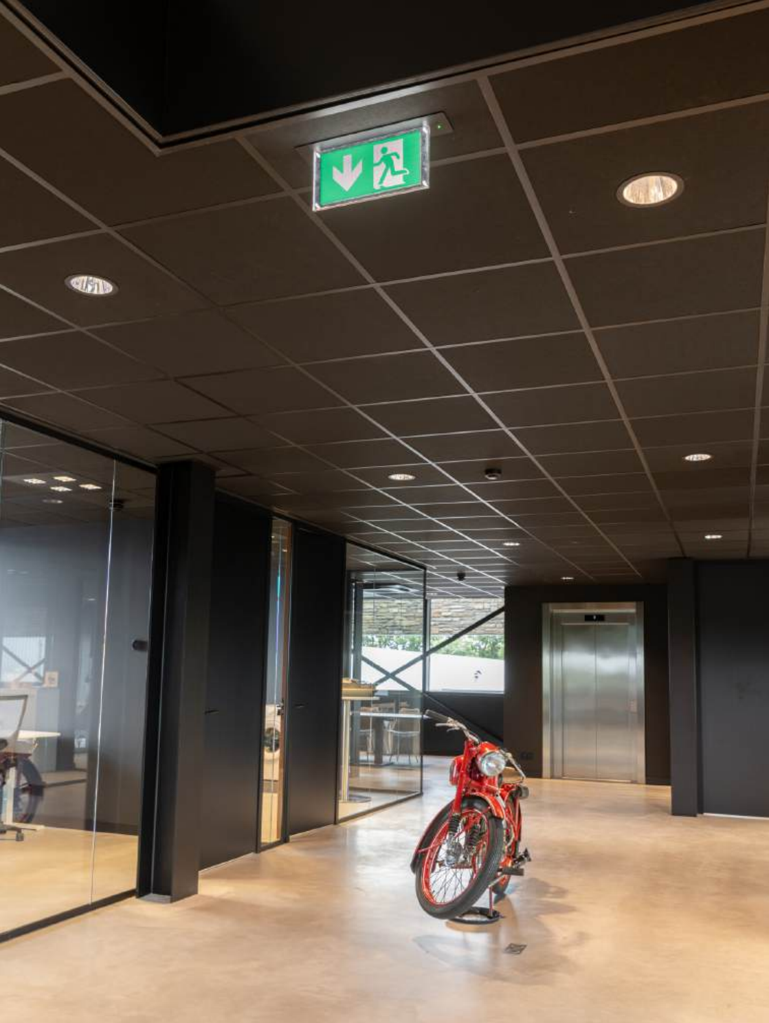
Downlights (136-454), led-panelen (173-063) en noodverlichting (600-018 en 600-032) in kantoorpand Strijbosch - Nistelrode
