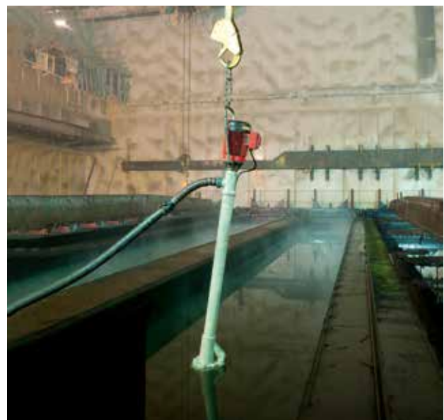
F 640 – Fördern verdünnter Salzsäure aus einem Beizbecken.
