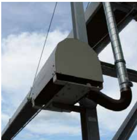
in Bodennähe montiert
