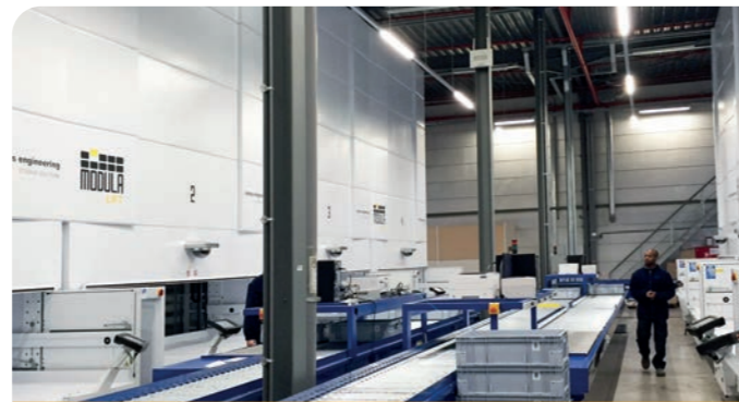
Kombination mit Förderbändern und Rollenförderern
