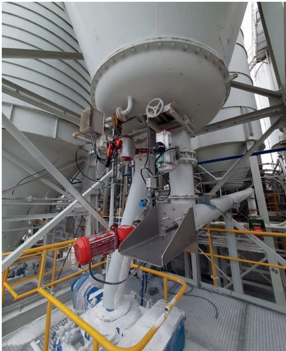
Afb. 1 De bunkersilo met daaronder een Van Beek schroeftransporteur waarvan de (rode) motorreductor nog in de takels hangt. Zie de astap en draadeinden voor de bevestiging van het flenslager.
