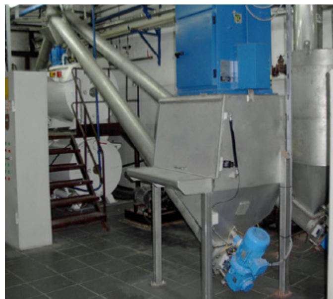
Zakkenstort met filterunit en doseerschroef
