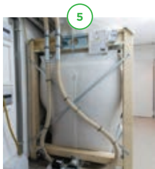
Silo à pellets
