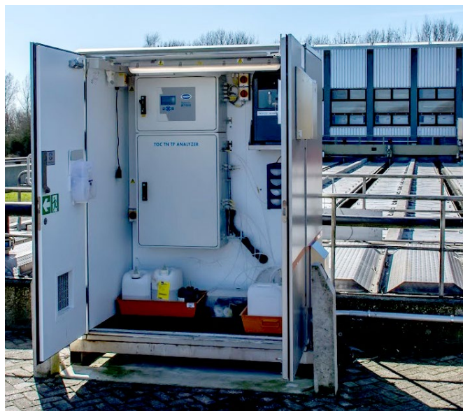
BioTector bij de waterzuiveringsinstallatie van Oijen
