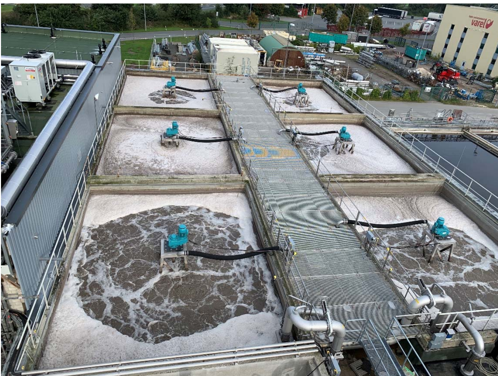
Foto 2: HYPERCLASSIC ® menger- en beluchtingssystemen in bedrijf bij de waterzuiveringsinstallatie van de papier- en kartonfabriek Varel
