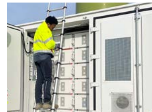
De batterijen worden door een vakkundige monteur aangesloten op het totale systeem.
